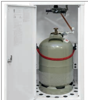
Einsicht in geöffneten Sockel mit angeschlossener Gasflasche
